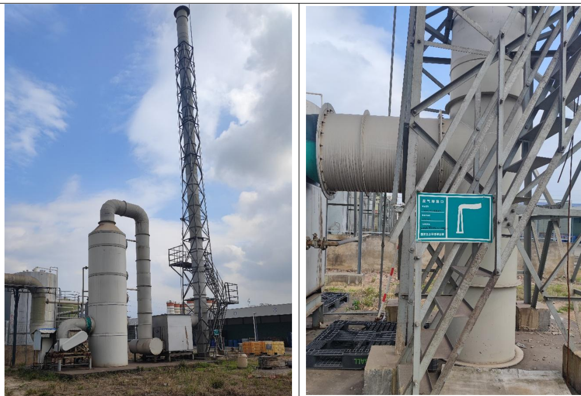
4#排气筒（DA003）及罐区废气处理系统
